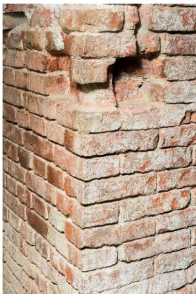
Obr. 1 Zdivo připravené na aplikaci sanačních hmot
