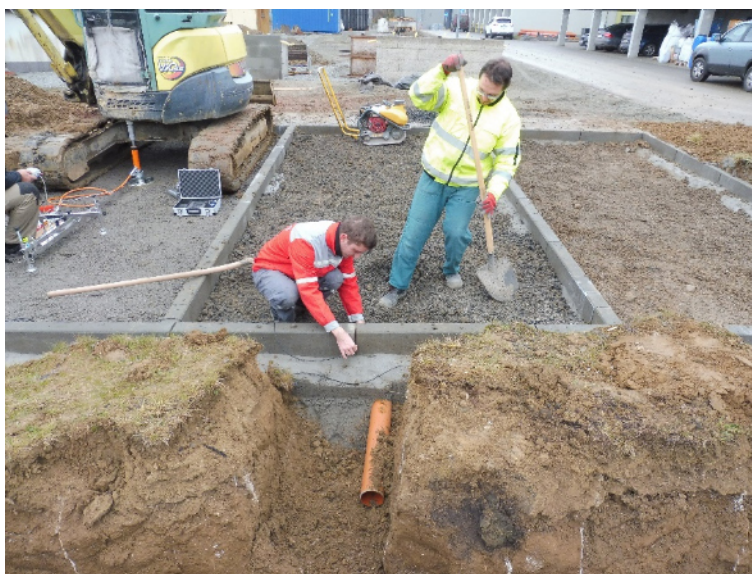
Provádění statických zatěžovacích zkoušek únosnosti (vlevo); instalace vlhkostních čidel a drenážního systému (popředí)
