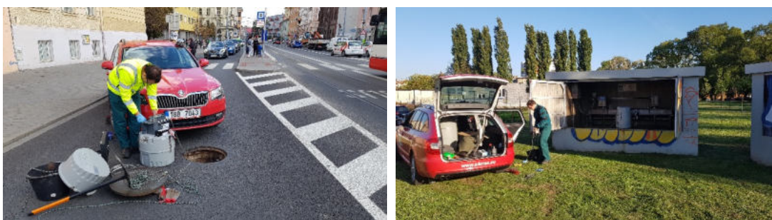
Obr. č. 29: Instalace a provoz automatických vzorkovačů ISCO
